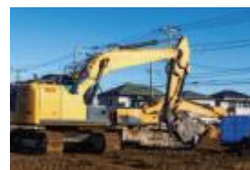
工事現場での電源確保
